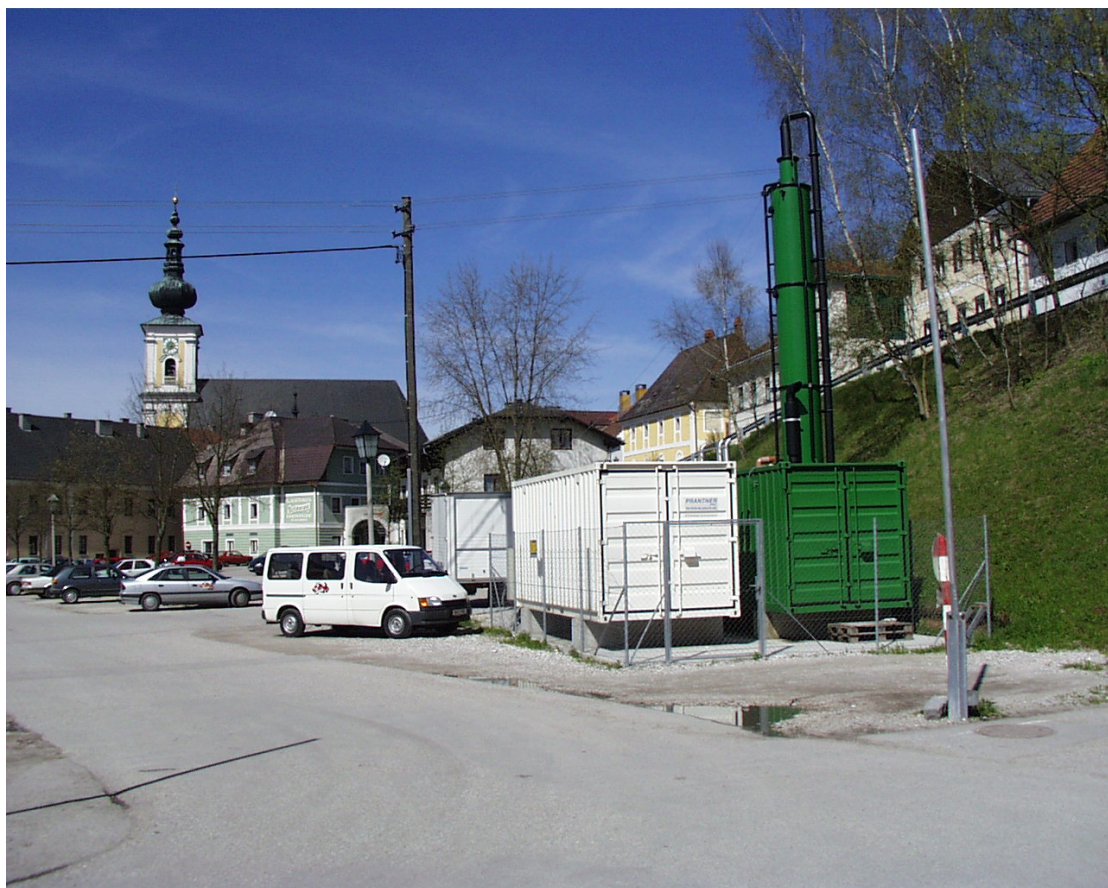
Abbildung 4: Grundwasserreinigungsanlage (rechter Container) und Stripkolonne
