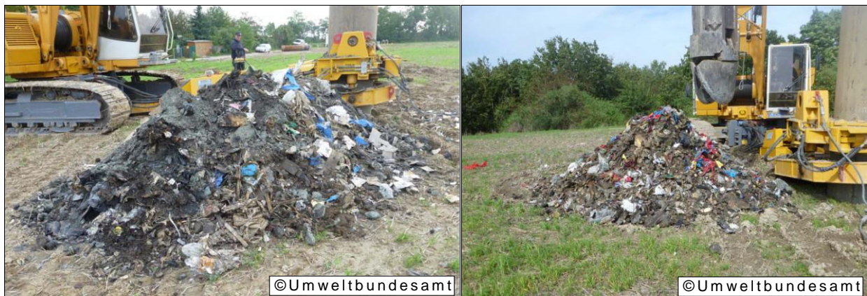
Abb. 6: Ablagerungen in den Greiferbohrungen GB 04 und GB 03
