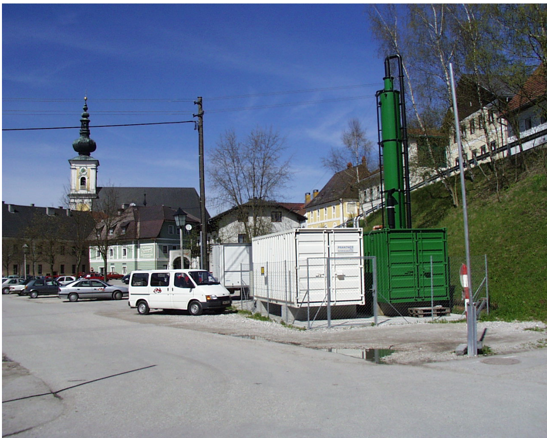
Abbildung 2: Grundwasserreinigungsanlage (rechter Container) und Stripppkolonne
